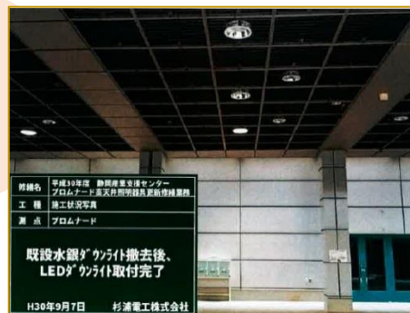
中央棟プロムナードは、エネルギー効率が良く、環境にやさしいLED照明に切り替えられた。
